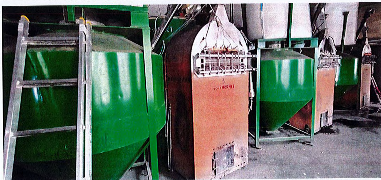
Fig. 6.17. Sub-contur 4: CT Integral, echipată cu 3 cazane ecoHORNET CTP 350 (525 kW fiecare)
