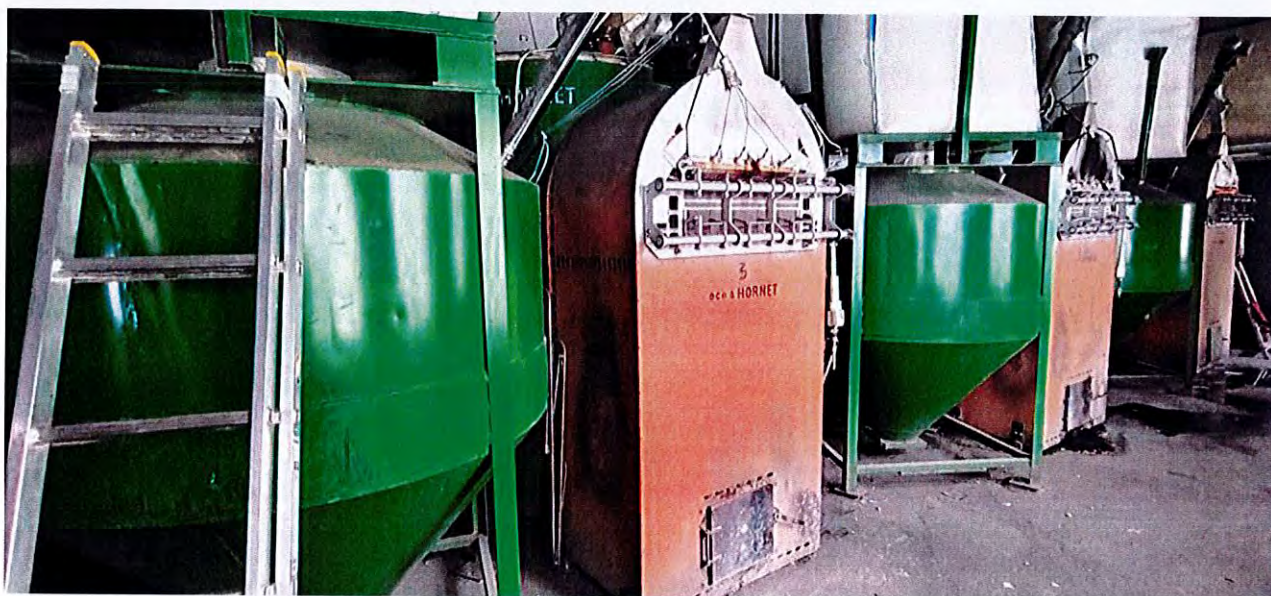
Fig. 2.8. Sub-contur 4: CT Integral, echipată cu 3 cazane ecoHORNET CT 350 (525 kW fiecare)
