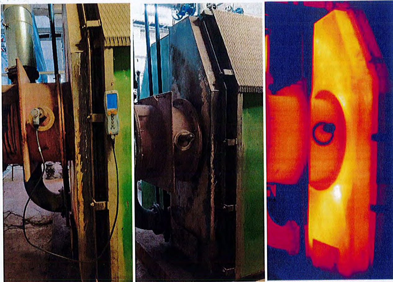
Fig. 6.f. CT4 Dorobanți: analiză gaze de ardere la cazanul HR3-3200, cu analizorul de gaze Testo 350, respectiv inspecție termografică pentru determinare pierderi de căldură prin pereții cazanului
